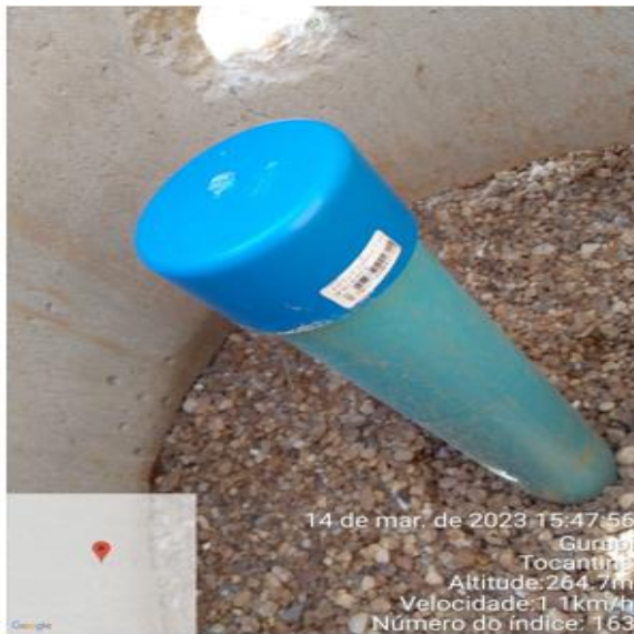
Figura 4 POÇO PIEZOMETRO TAMPADO
